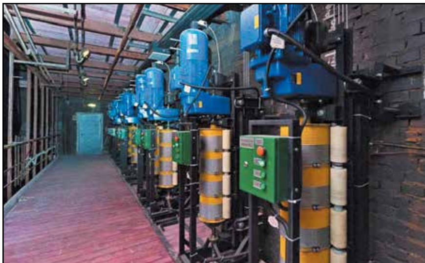
Рис. 1. Штанкетные лебедки с кнопочными пультами местного управления производства Schneider Electric
