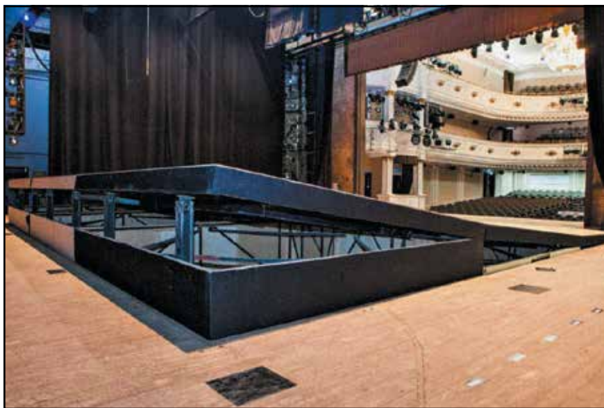
Рис. 5. Подъемный механизм сцены
