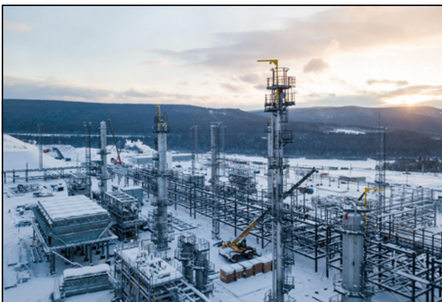
Строительство завода полимеров является частью масштабного проекта “Иркутской нефтяной компании”. Фото с сайта: irkutskoil.ru
